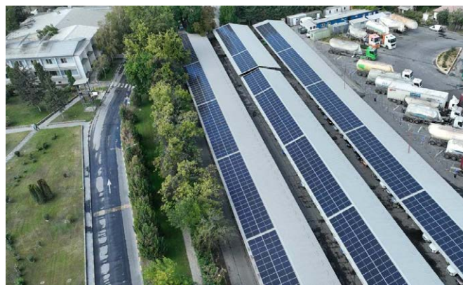
Centrale solaire photovoltaïque à la cimenterie d'Usje, Macédoine du Nord
